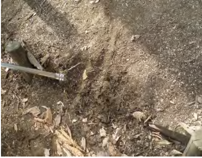
[3/10 階段破損箇所]
