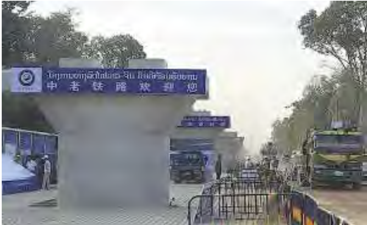
「一带一路」の象徴的プロジェクトとして、ラオスのビエンチャン近郊で建設が進む中国ラオス高速鉄道(2日) (読売171113)
