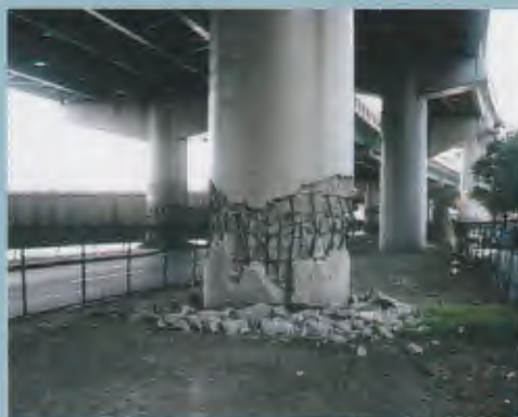
地震による橋脚の損壊状況
