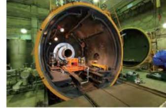
角田ロケット高空性能 試験設備
